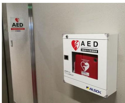
[本社ビル1階AED設置]
