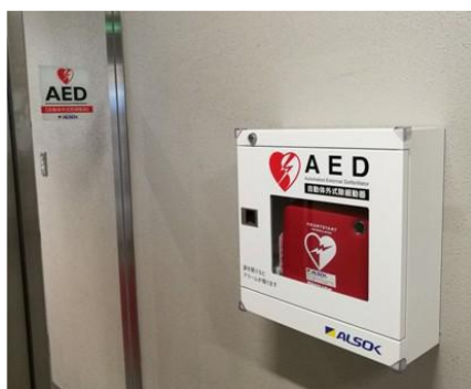
[本社ビル1階AED設置]
