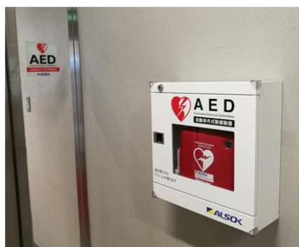
[本社ビル1階AED設置]
